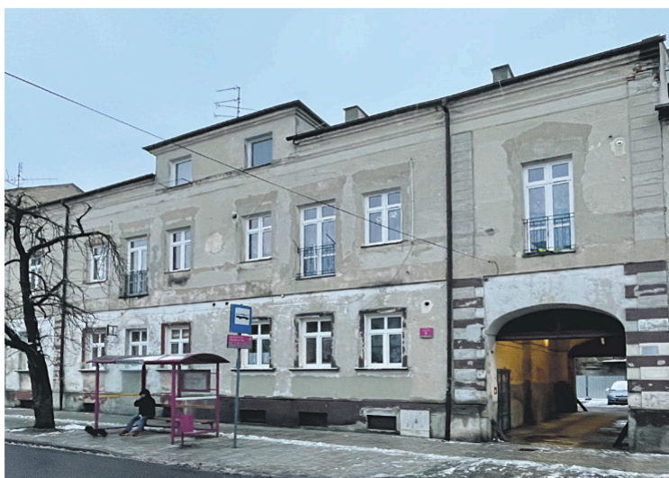
Zaniedbana kamienica szpeci zabytkową ulicę Sienkiewicza.
